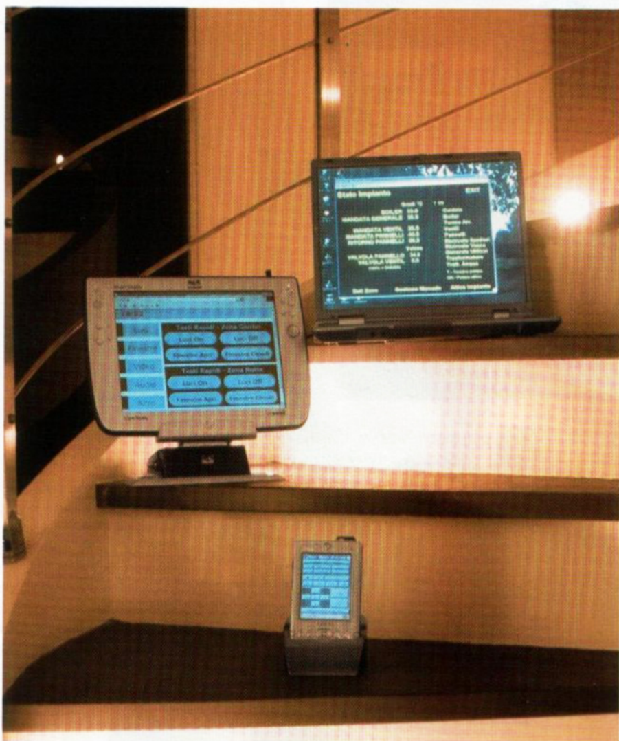
Una veduta d'insieme dei touch screen del sistema di controllo. Notare in basso il palmare cui abbiamo fatto riferimento in altre parti.
