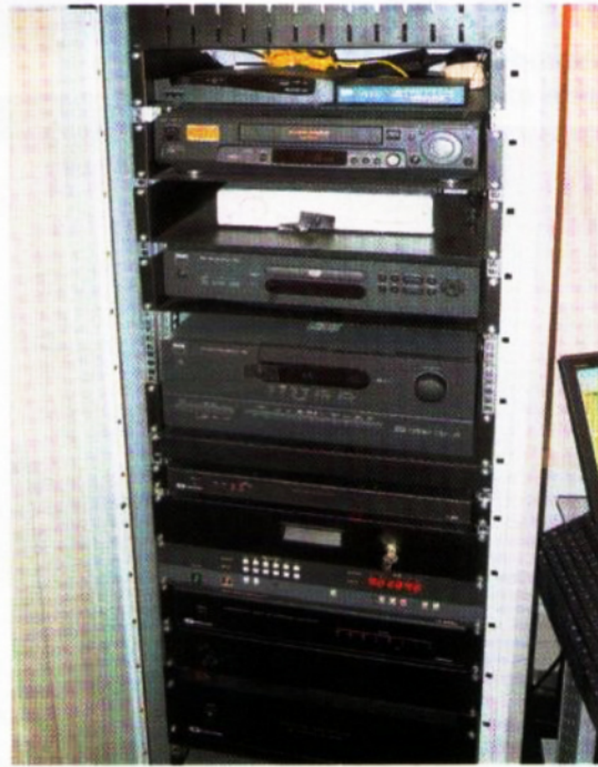
Veduta d'insieme del quadro tecnico. Particolare del mobile rack che contiene i componenti del sistema di intrattenimento e i controller Crestron che realizzano parte dell'automazione
